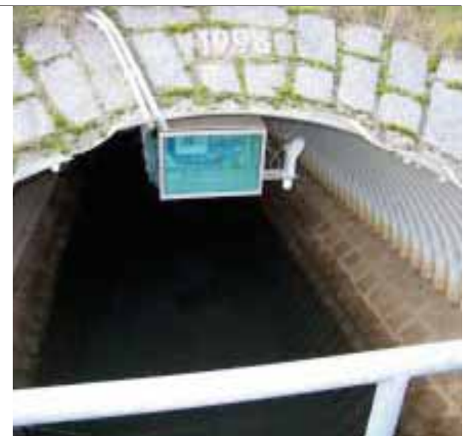
Mérési pont az öntözőcsatorna-átereszben
