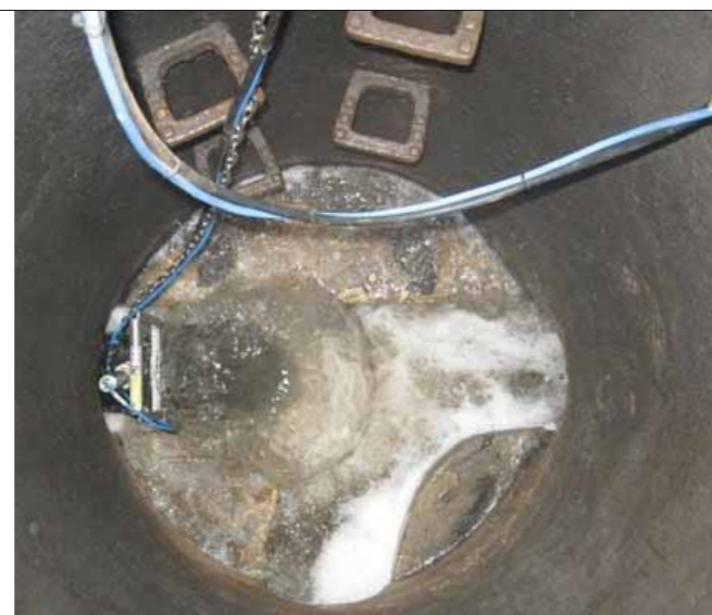
A beépített referencia mérőrendszer: NIVUS Pipe Profiler (NPP)
