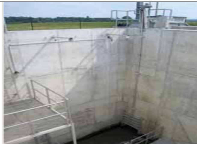
Az emelő berendezés befolyó oldala
