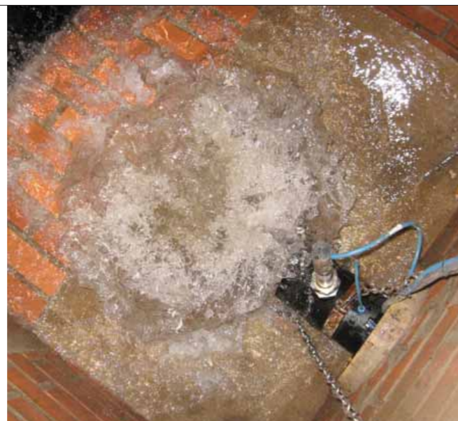
Összehasonlító mérés a NIVUS Pipe Profiler alkalmazásával
