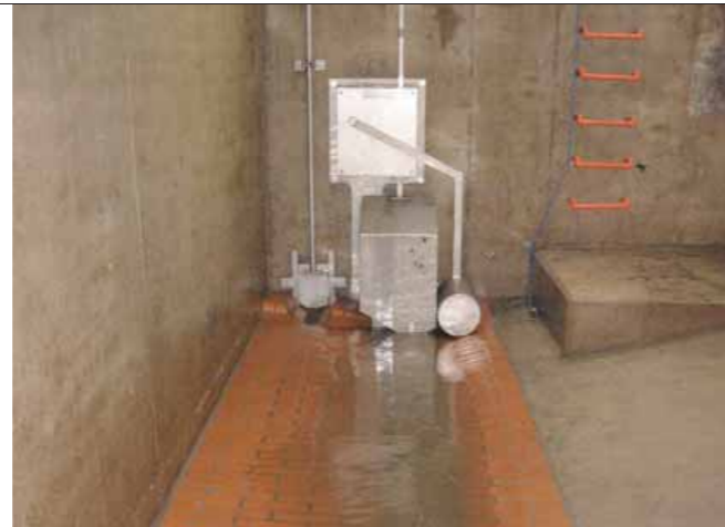
Záporvíztározó – főgyűjtő mechanikusan szabályozott fojtószeleppel
