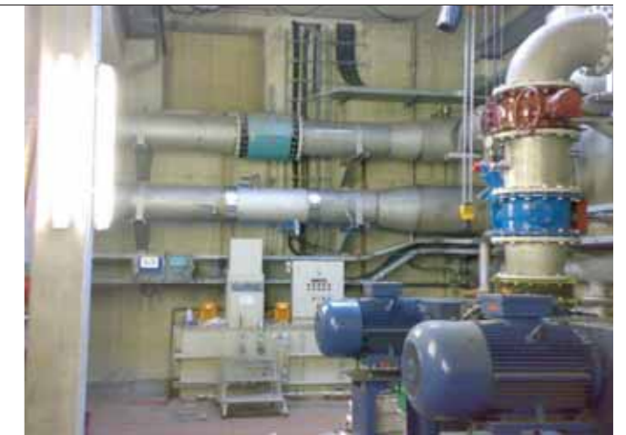
Szivattyúház, ürítővezetékek a hátsó falon
